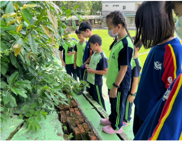
看臺因樹根破壞導致崩裂
