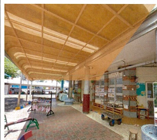
延伸遮雨棚形成雜物堆放區，影響幼童空間動線及美感覺知
