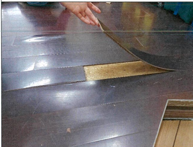
教室室內木地板老舊損壞
